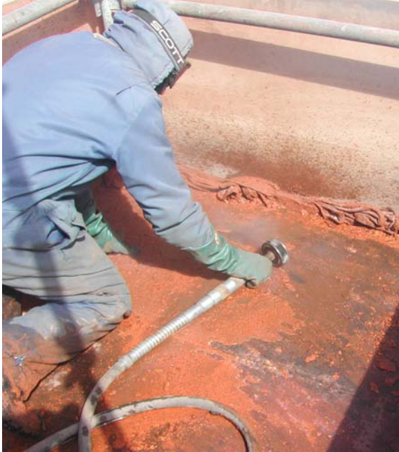
Figura 5 – Equipamento utilizado para promover a raspagem das porções corroídas de superfícies metálicas lisas.
