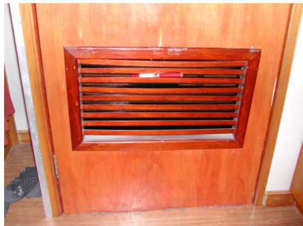
Figura 9 – Venezianado para renovação do ar instalado na parte inferior da porta de acesso aos camarotes.
