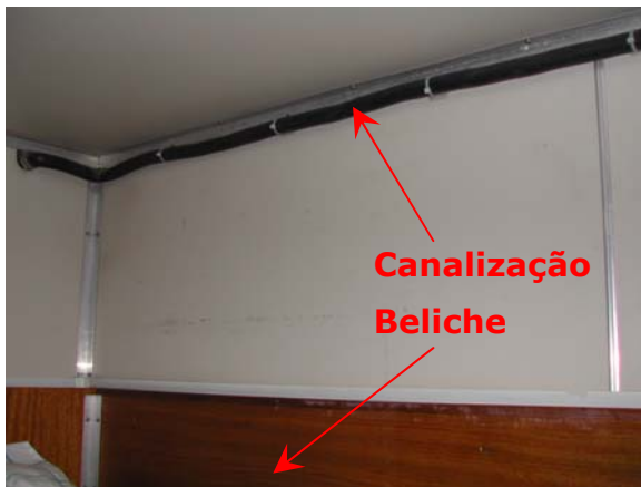
Figura 8 – Cano de água quente do sistema de aquecimento da EACF.
