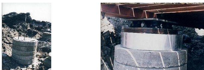
Figura 4 – Sapatas originais da Primeira ECASPSP. À esquerda, bolachas de concreto unidas por camada de manta asfáltica e barras rosqueadas e à direita, vista geral do conjunto com amortecedores. Fonte: LPP/UFES, 1998.
