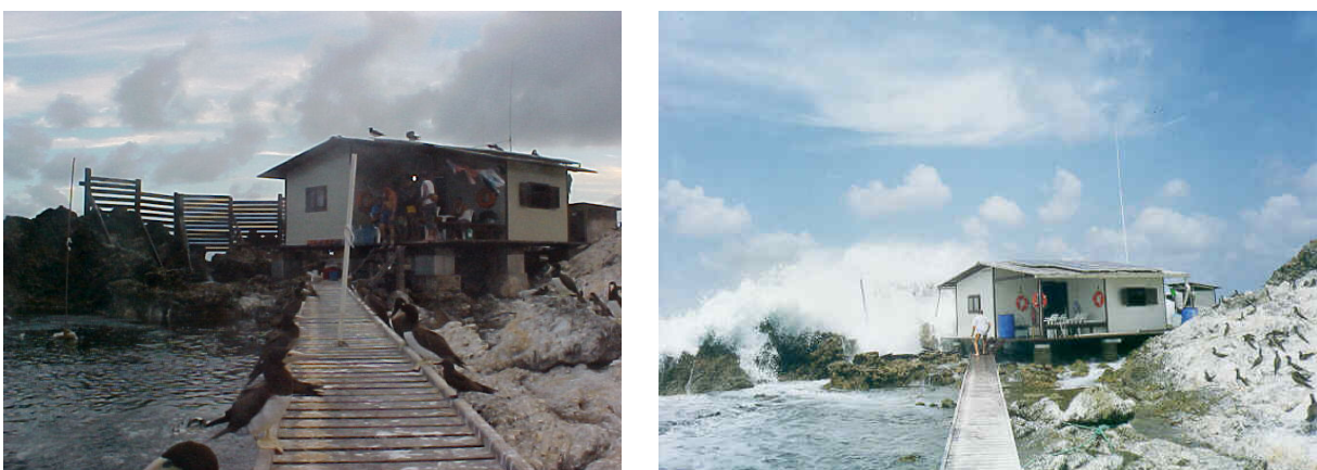
Figura 4 – O muro de contenção (à esquerda), embora alcance o objetivo de reduzir a energia das ondas, é constantemente avariado causando desconforto e profunda sensação de insegurança nos usuários. Na imagem à direita, exemplo de onda comum em determinadas épocas do ano.
