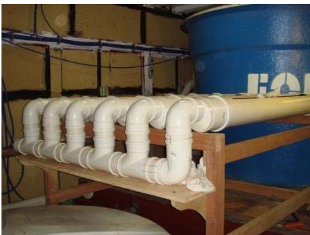
Figura 5 – Detalhe do reator UV instalado na EACF
