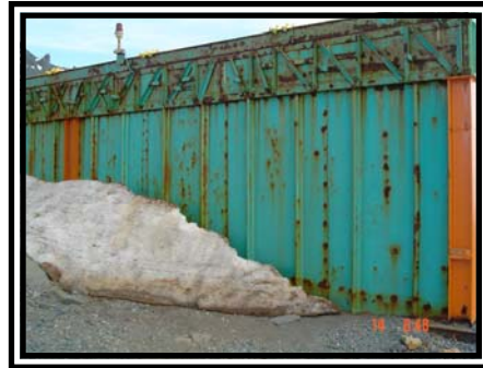
Figura 1- Corrosão da antepara lateral do heliponto.
