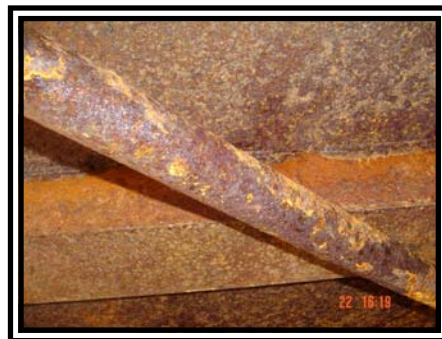
Figura 2- Corrosão do fundo do tanque de óleo combustível.
